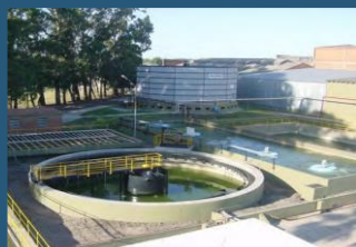
Tratamiento del agua
