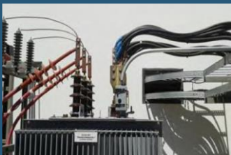
Generación de energía
